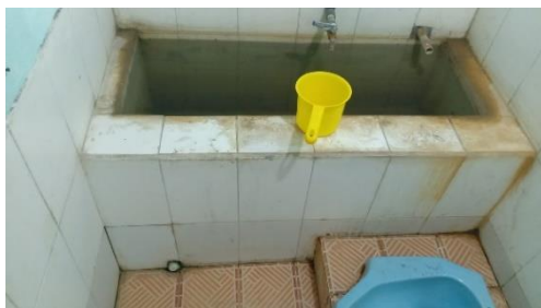
Gambar 1. Kondisi Air Bersih di SD Negeri Kalidadap
