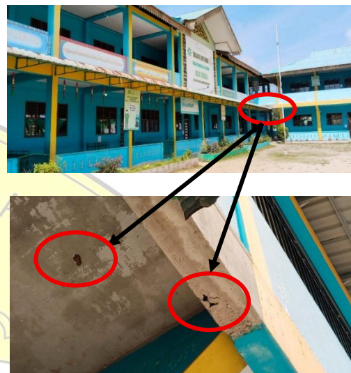
Gambar 10 Area kerusakan pada balok dan plat lantai bangunan C1-2TBH
