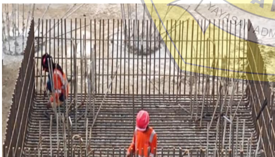
Gambar 7. Penjangkaran tulangan bor pile yang tidak diluruskan.
